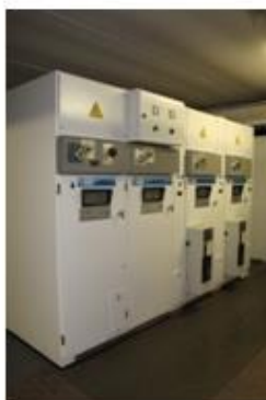
Quadro di Media Tensione
