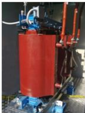
Trasformatore Media/Bassa Tensione
